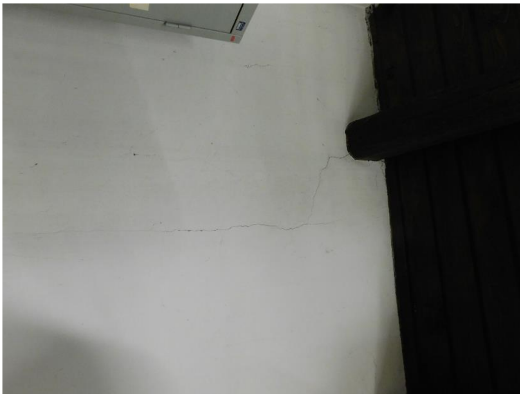
Foto 38 – Vista ravvicinata lesione sub-verticale, archivio storico
