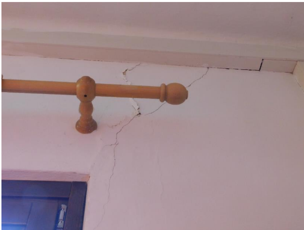
Foto 20 – Vista ravvicinata lesione soprafinestra inclinata, locale salone polivalente
