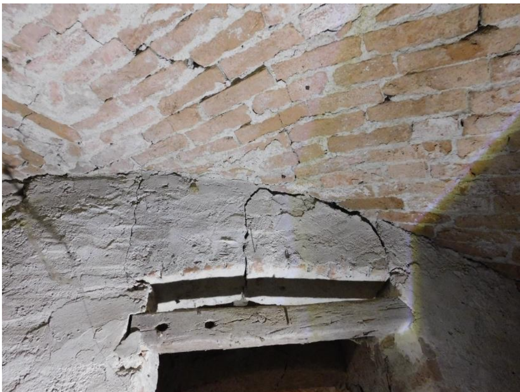
Foto 30 – Vista lesioni e architrave in legno, locale seminterrato
