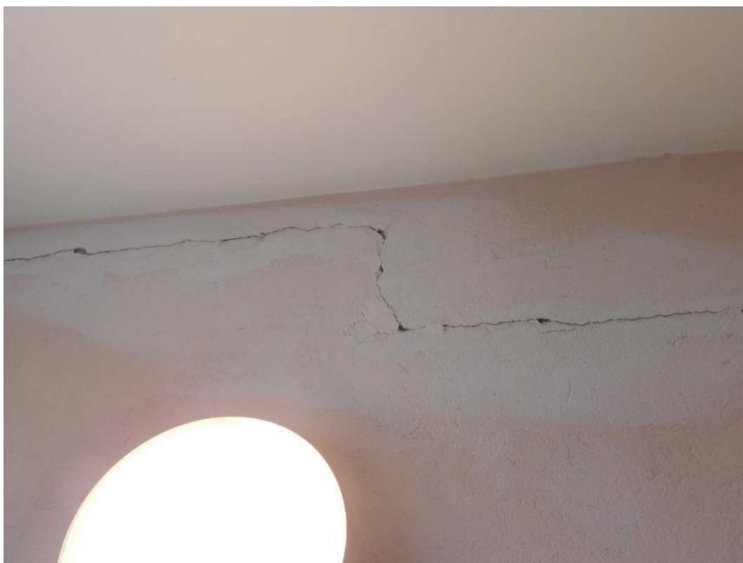
Foto 16 – Vista ravvicinata lesione sub-orizzontale, locale bagno
