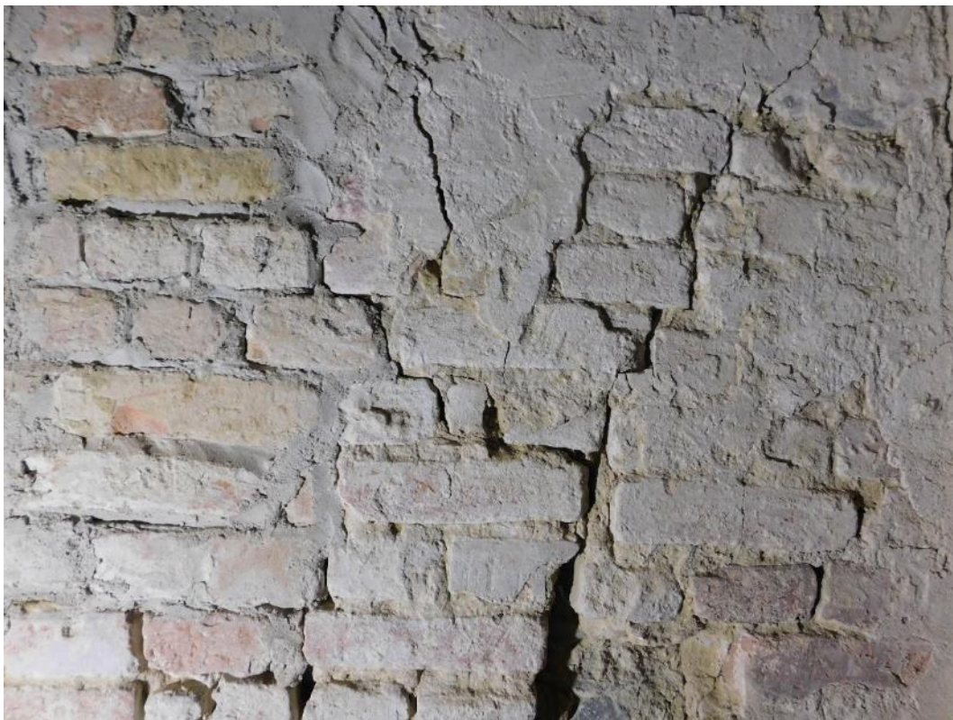
Foto 29 – Vista lesione locale seminterrato
