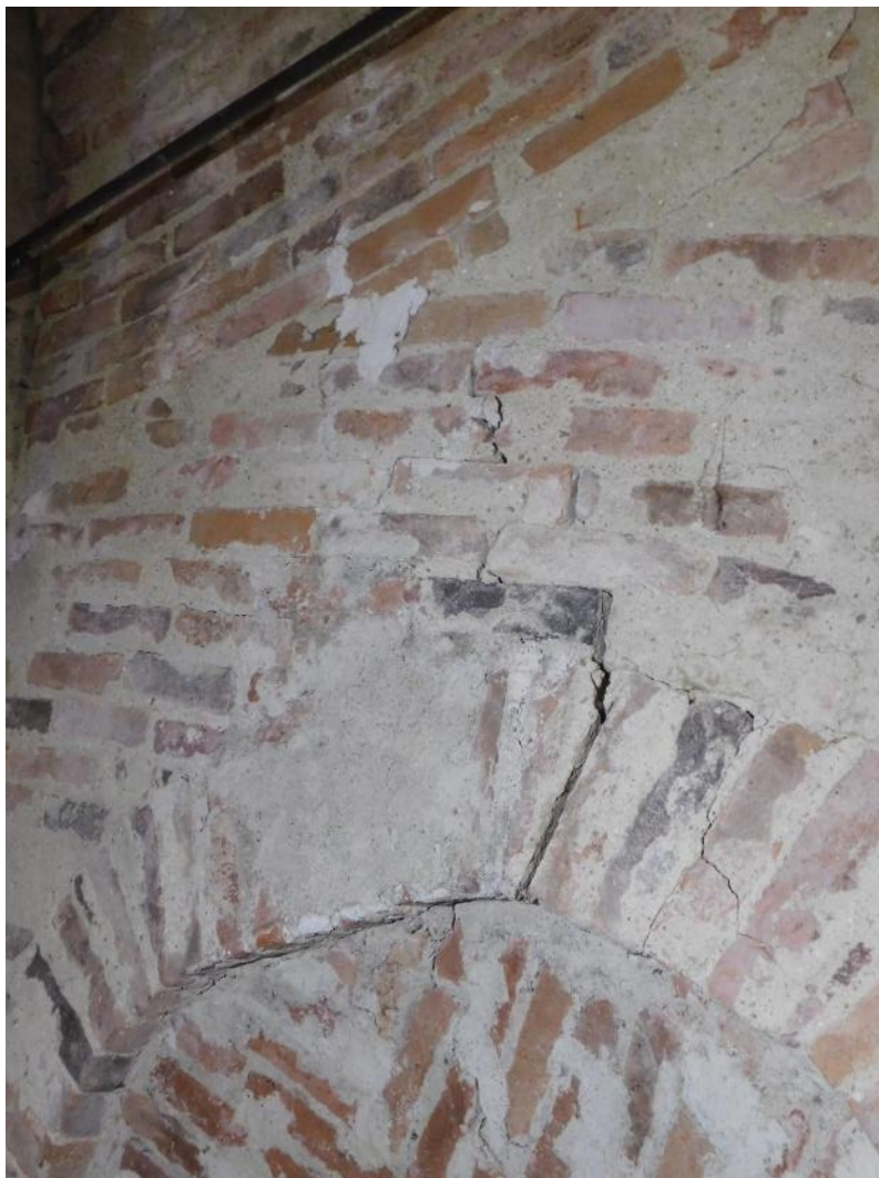
Foto 22 – Vista ravvicinata lesione locale seminterrato
