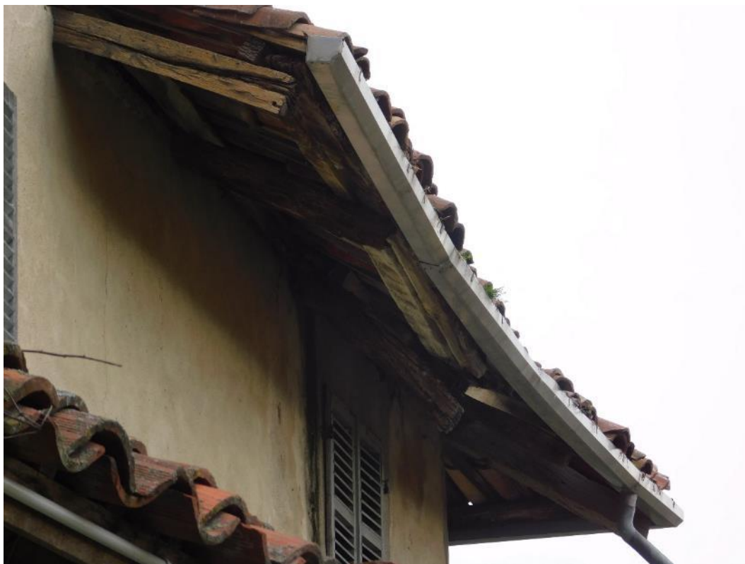
Foto 48 – Vista ammaloramento copertura in legno fabbricato B
