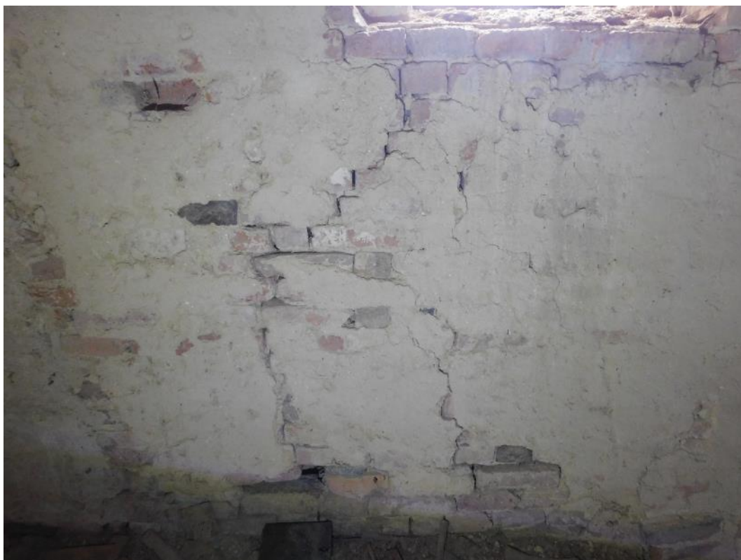
Foto 21 – Vista ravvicinata lesione sottofinestra locale seminterrato
