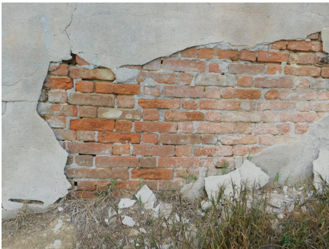
Foto 51 – Vista ravvicinata prospetto Sud ammaloramento muratura
