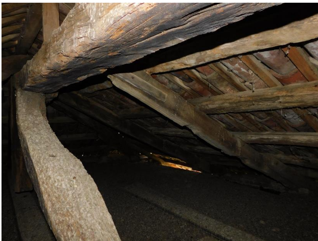
Foto 42 – Vista ammaloramento copertura fabbricato B
