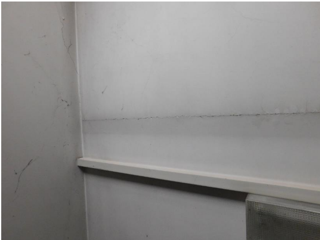
Foto 34 – Vista lesione intradosso sottotetto fabbricato B
