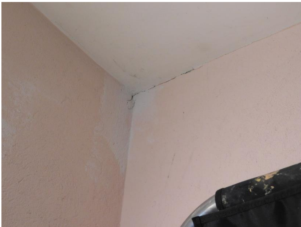
Foto 18 – Vista ravvicinata lesione orizzontale, locale polivalente
