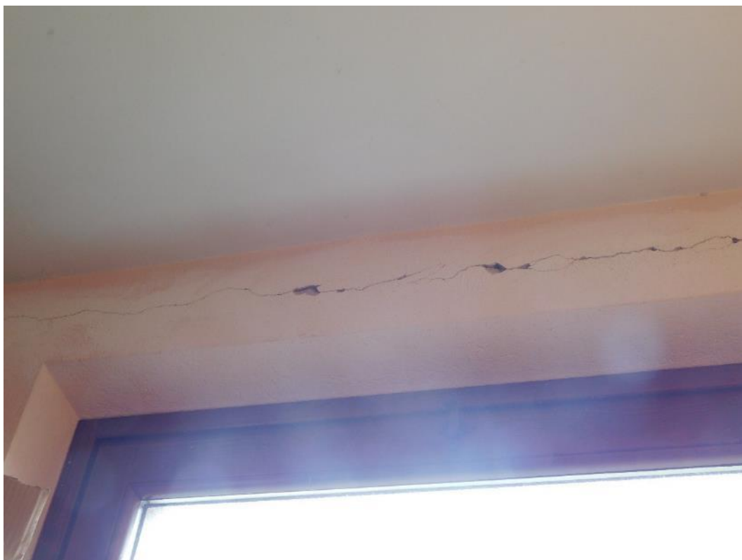
Foto 17 – Vista ravvicinata lesione orizzontale, locale salone polivalente
