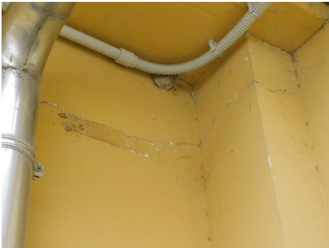
Foto 5 – Vista ravvicinata lesione sub-orizzontale
