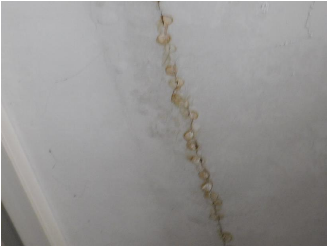
Foto 35 – Vista lesione intradosso sottotetto fabbricato B
