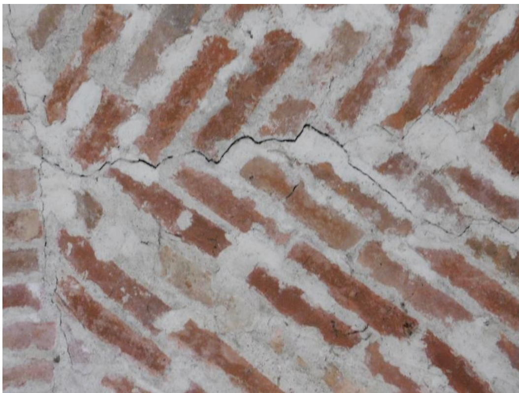
Foto 27 – Vista lesione locale seminterrato
