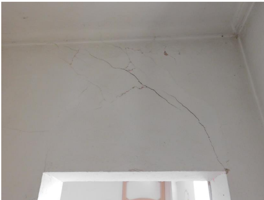
Foto 32 – Vista lesione sub-diagonale locale disimpegno
