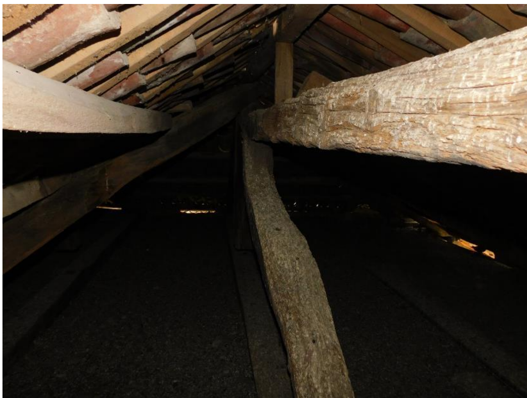
Foto 41 – Vista ammaloramento orditura fabbricato B
