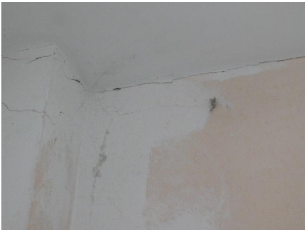
Foto 19 – Vista ravvicinata lesione sub-orizzontale ad angolo, locale salone polivalente
