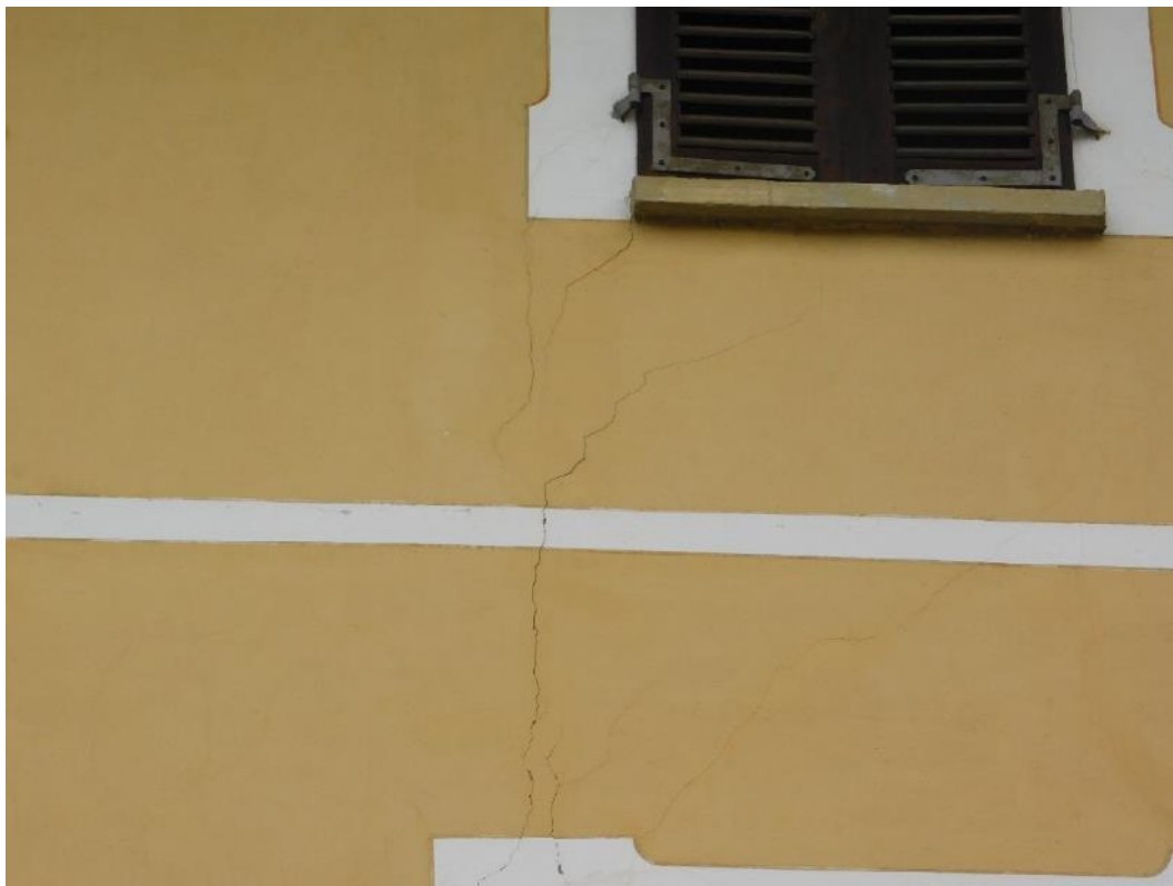
Foto 11 – Vista lesione verticale piano primo
