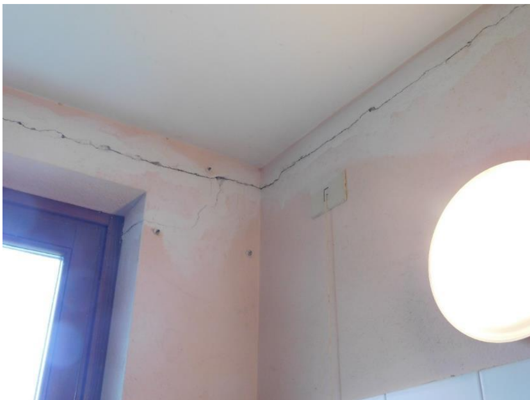
Foto 15 – Vista ravvicinata lesione orizzontale, locale bagno
