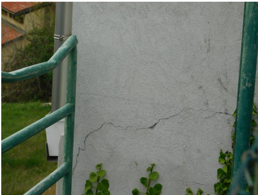
Foto 14 – Vista ravvicinata lesione esterna, prospetto Est
