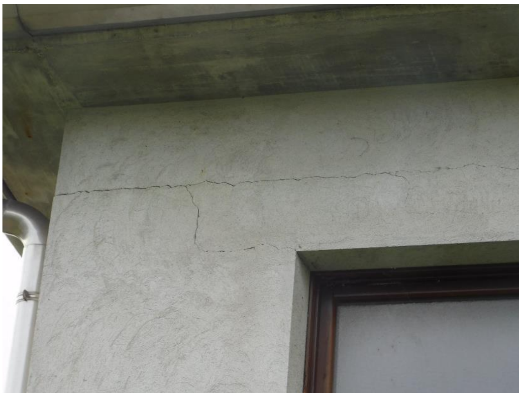
Foto 13 – Vista ravvicinata lesione sub-orizzontale esterna, prospetto Est
